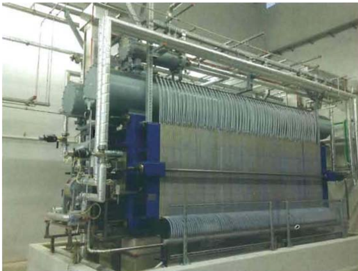
Bild 7: Elektrolyseur (Alkali-Elektrolyse bei Umgebungsdruck; eingesetzte elektrische Leistung 2 MW; Audi e-Gas-Anlage Werlte [25])
