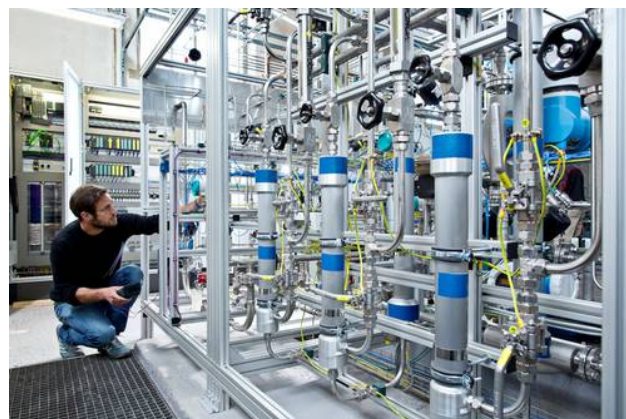
Bild 9: Methanisierungsanlage im Zentrum für Solarenergie- und Wasserstoffforschung (ZSW) in Stuttgart [52]
